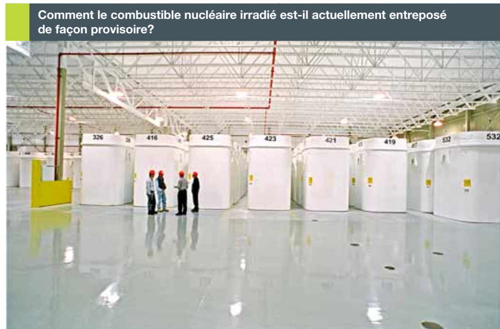
Les conteneurs de stockage à sec pour combustible nucléaire irradié à l'installation de gestion des déchets de Western d'Ontario Power Generation
